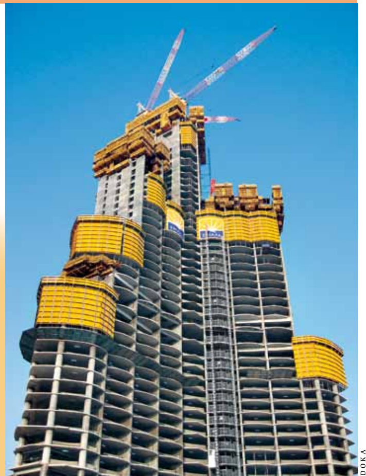
Hoch: In 600 Meter Höhe ist die Schalung von Doka geklettert. Das System wurde extra für die Baustelle weiterentwickelt.
